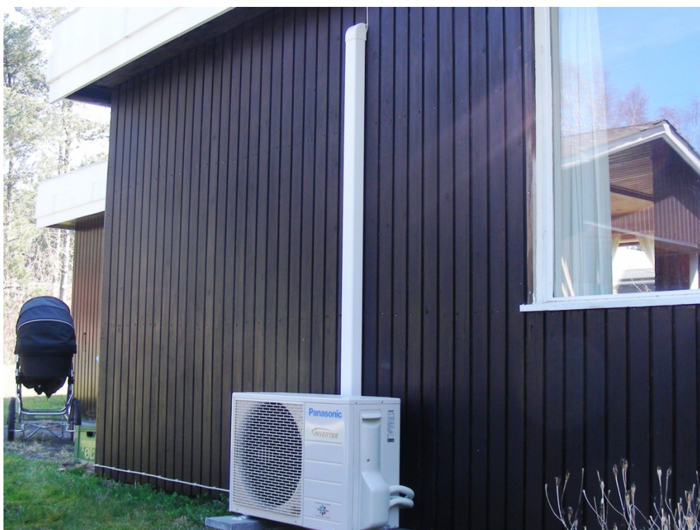
Figur 3: Udedel til en luft/luft-varmepumpe.
